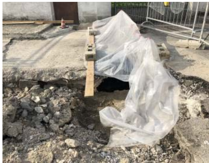
Il punto in cui si è verificato l'avvallamento nella strada con il foro
